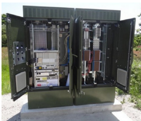
Figure : DSLAM: Multiplexeur d'accès DSL. De 500 à 1000 lignes abonnés 41 .
